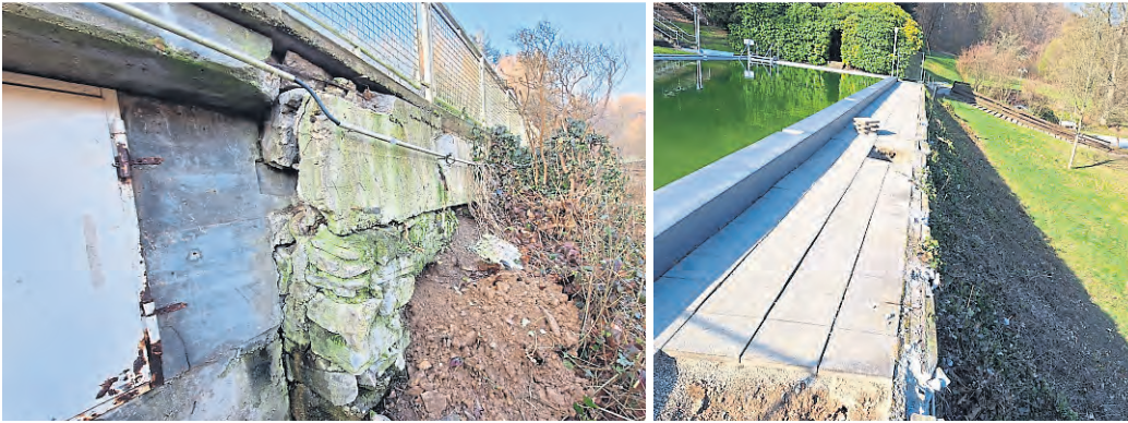
Marode Stützwand unterhalb des Beckens im Thermalfreibad. Ansicht von oben. Bilder: Gemeinde Schlangenbad
